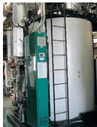
福島プラスチック(株) LNG炊ボイラー
