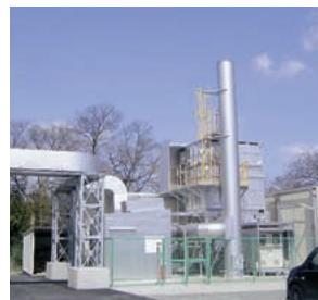
電子部品事業部 VOC除去設備
