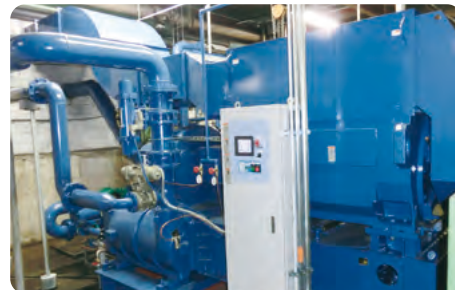
ターボコンプレッサ: 圧縮した空気を高効率で供給
