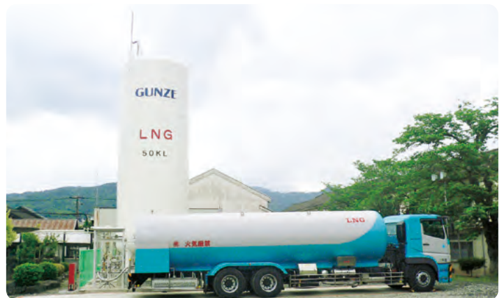
LNGサテライトタンク設備/宮津工場
