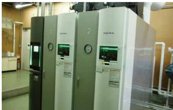
江南工場貫流ボイラー
