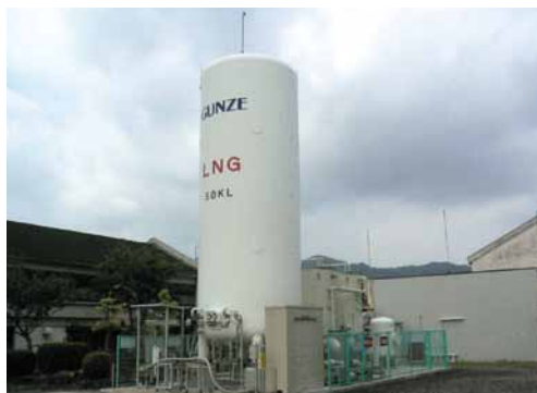
宮津工場ボイラー燃料タンク
